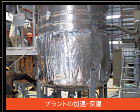
配管の保温・凍結防止
